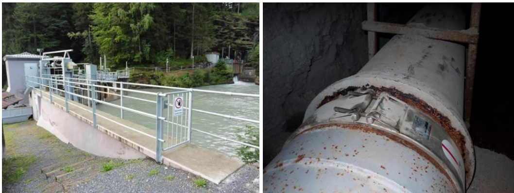
Abbildung 15: links = Stauweiher Zwirgi, rechts = Druckleitung im Stollen
