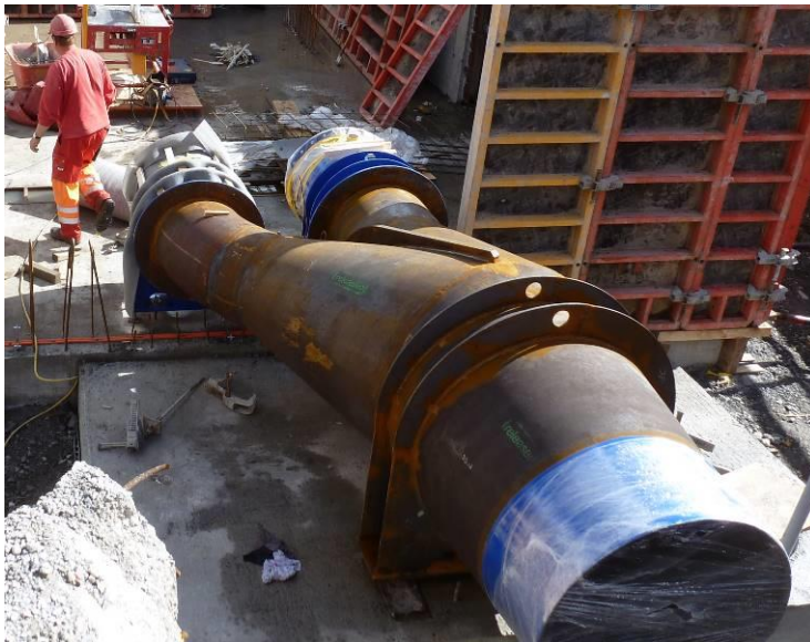
Abbildung 20: Verteilrohr im Kraftwerk Gsteig (2014)
